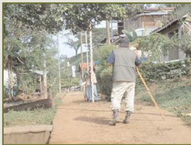
Octubre 2004. Realización de los trabajos de topografía para el diseño del sistema de saneamiento en el Poblado de El Castillo.
